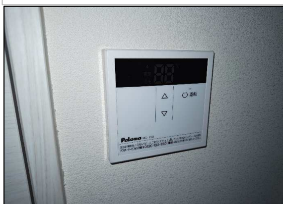
ガス給湯器・リモコン
